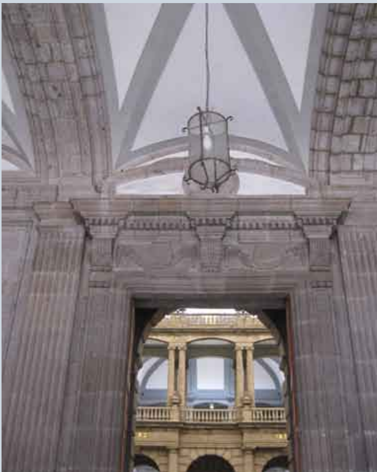
El dintel adovelado con ménsulas y guirnaldas remata una de las puertas que da hacia el patio
